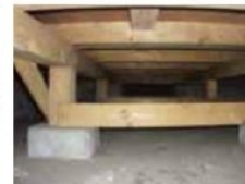
【床下の腐朽・白アリ】
